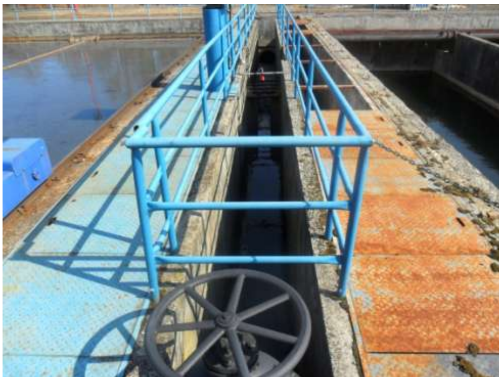
Príloha 36 Odtokový žľab z dosadzovacej nádrže
